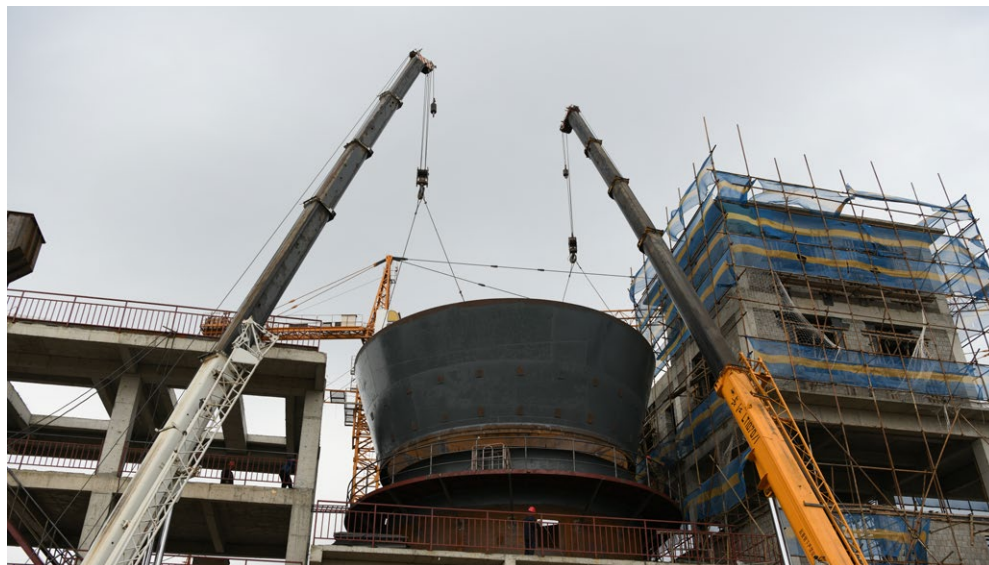
疫情期间，新都公司整体搬迁改造工程吊装焙烧炉施工现场
