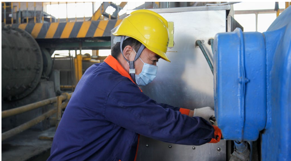
王兴伟带领工友一起检修设备，保障疫情期间有序生产
