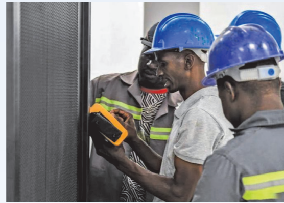
在博茨瓦纳国家数据中心，几名工人在数据库房工作
