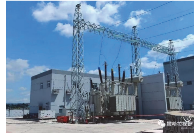
刚果（金）金苏卡220千伏变电站项目
