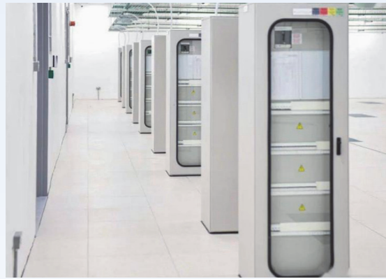
博茨瓦纳国家数据中心数据库房
